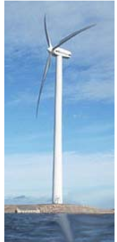
Lumituuli Oy:n voimalaitos Lumijoella tuottaa tuulisähköä verkkoon.
