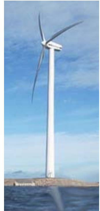
Lumituuli Oy:n voimalaitos Lumijoella tuottaa tuulisähköä verkkoon.
